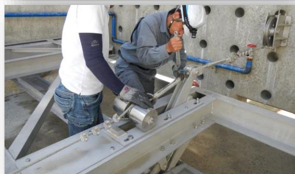
経年使用で伸びてしまった ワイヤーロープと張り調整状況
