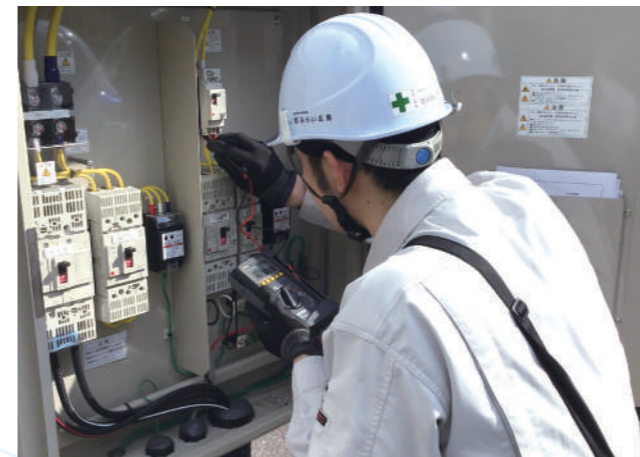
【電気保安業務】 小水力発電事業の電気保安業務を実施
